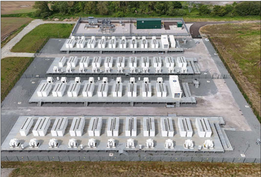
Planta de almacenamiento mediante baterías. ALAMY
